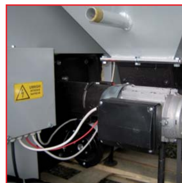
Instalación eléctrica acabada. Sólo es necesario enchufar a red.
