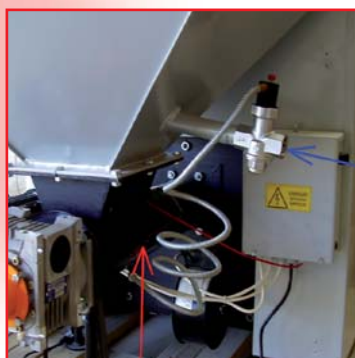
Conexión preparada para sistema de protección de retroceso de llama por rociador.
